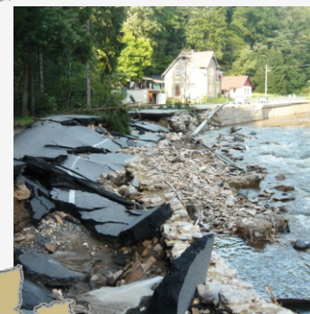
Silnice poškozená povodní v roce 2010 - Nová Ves
